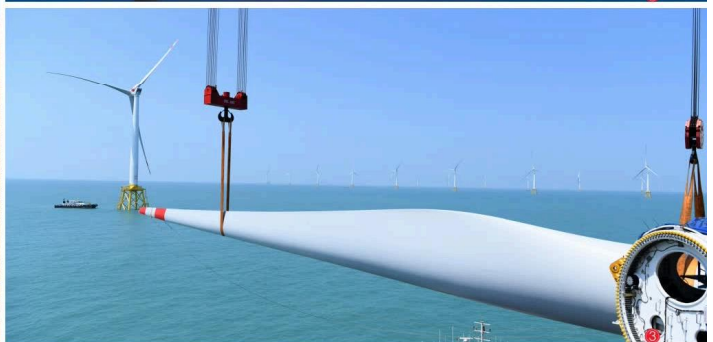
Parque Eólico Offshore de 90 MW de Tan Thuan, Vietnã (EPC) 越南新顺 90MW 海上风电场 (工程总承包) 2 Com uma capacidade instalada de 90 MW, é o maior projeto de energia eólica offshore no exterior em termos de capacidade, em operação comercial, contratado por uma empresa chinesa. 90MW, 迄今为止, 中国企业总承包并投入商业运行的最大容量境外海上风电项目。
