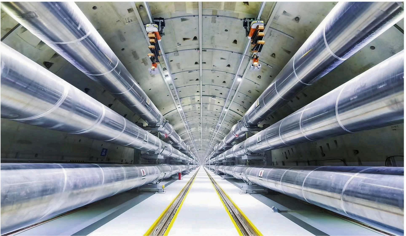
Projeto de Túnel Utilitário Integrado de 1.000 kV GIL de Suzhou-Nantong, em Jiangsu, China (Levantamento e Design) 中国江苏 1000kV 苏通 GIL 综合管廊工程 (勘察设计)
